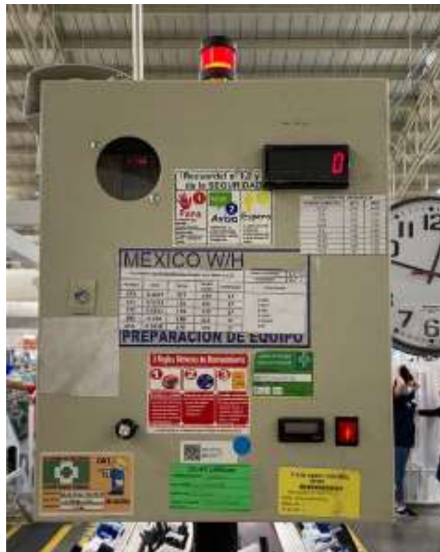
Ilustración 61 Caja de control de conveyor.
